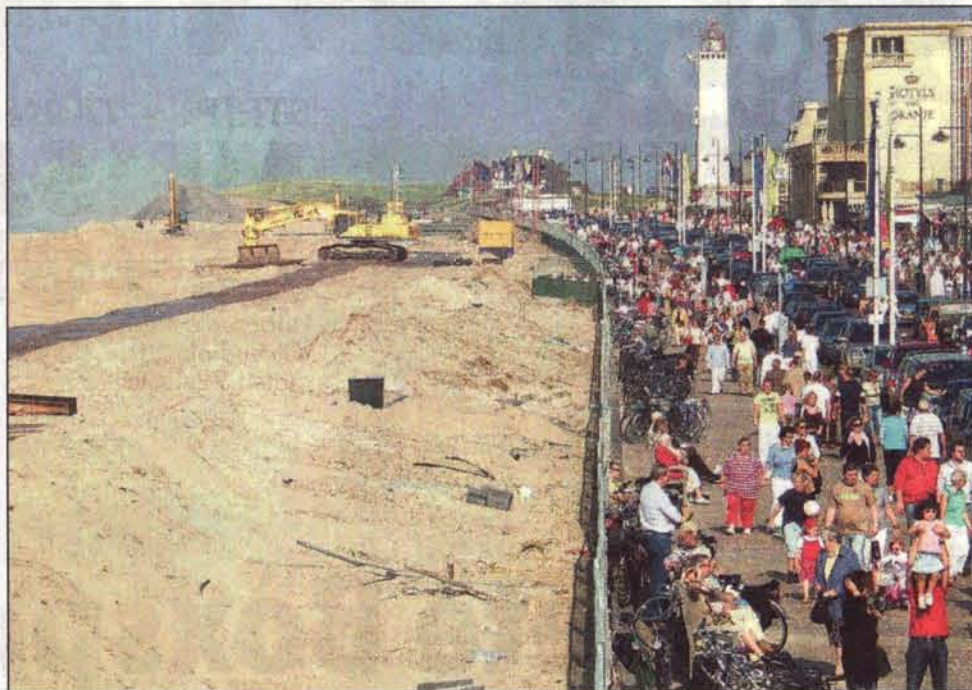
De werkzaamheden voor de kustversterking trekken vooral tijdens de weekends veel belangstelling. (foto: www.actief-in-noordwijk.nl)
